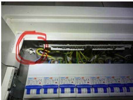
Utett skrog-gjennomføring i sikringskap.
