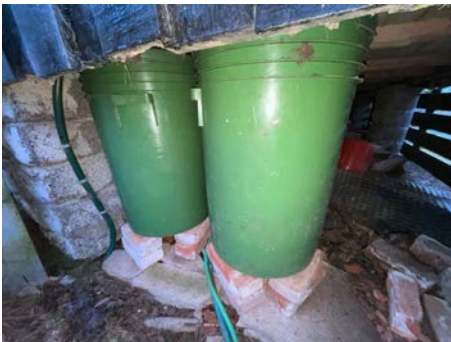
Bøtter stående under stubbegulv.
