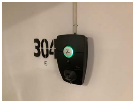
El.bil-lader er montert ved parkeringsplass i kjeller.
