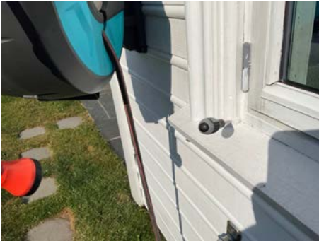
Råteskade i belistning 1etg.
