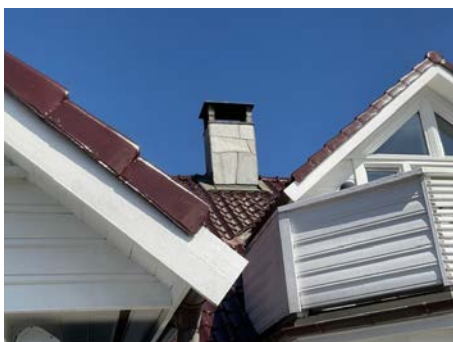
Beslag i bunnen av pipe.
