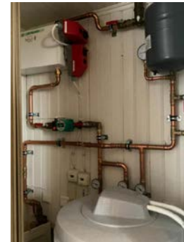
Rørføringer til vannvarmeanlegget.
