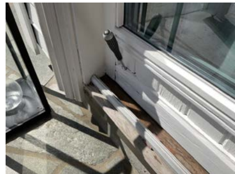
Skyvedør i stue. Betydelige råteskader.
