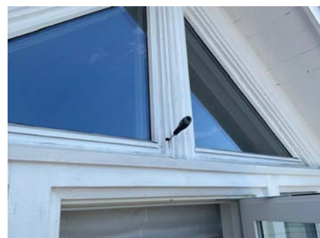
Råteskade i belistning Zetg.
