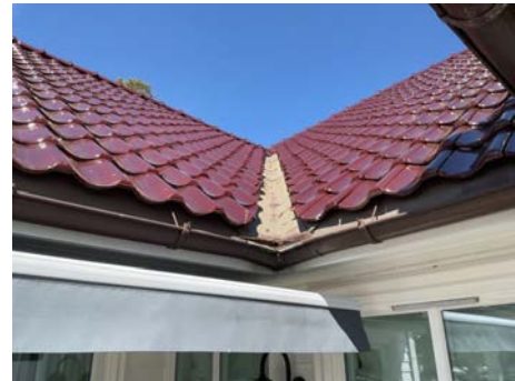
Slitasje i kilrennebeslag.
