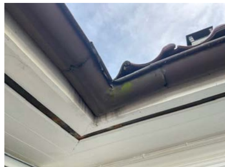
Lekkasje i renne.
