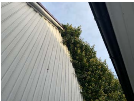
Vegetasjon mot bygningen reduserer levetiden og øker sjansen for råteskader.
