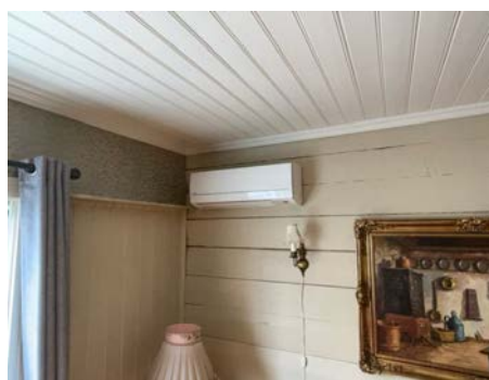
Varmepumpe, innvendig komponent.
