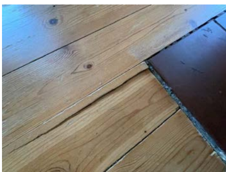
Sprekk og svikt i gulv.
