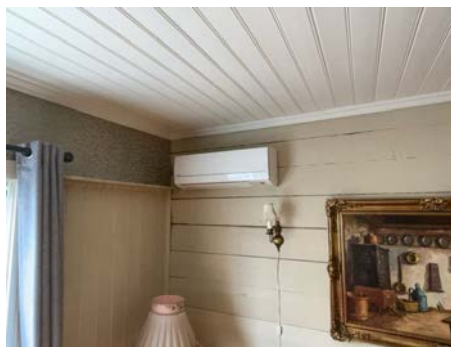
Varmepumpe, innvendig komponent.
