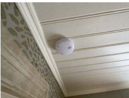
Røykvarslere i 1 etasje.
