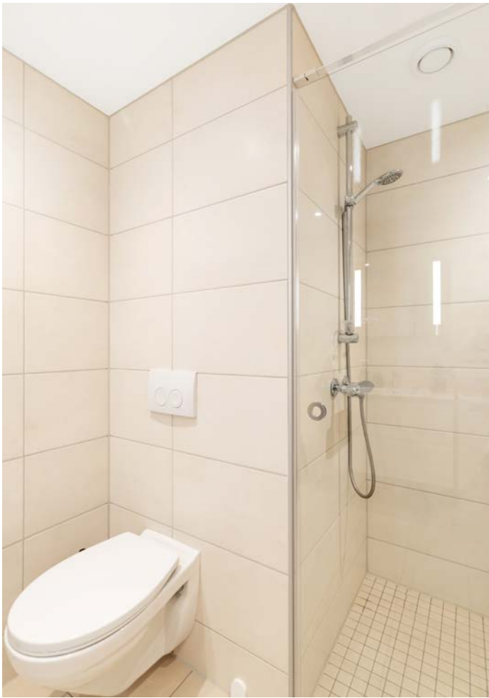
Vegghengt wc og dusjhjørne
