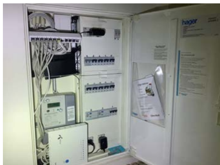
Sikringskap står montert i bod.
