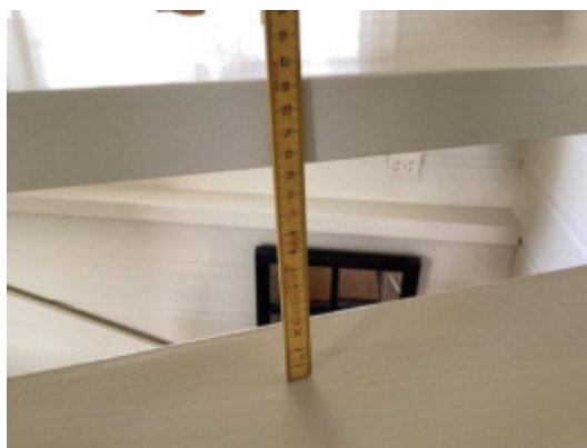
Åpning mellom trinn er større enn dagens krav på 10cm
