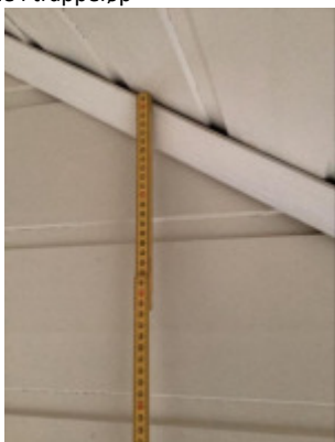
Det er liten frihøyde i trappeløp
