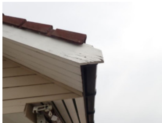
Råteskader på vindskier
