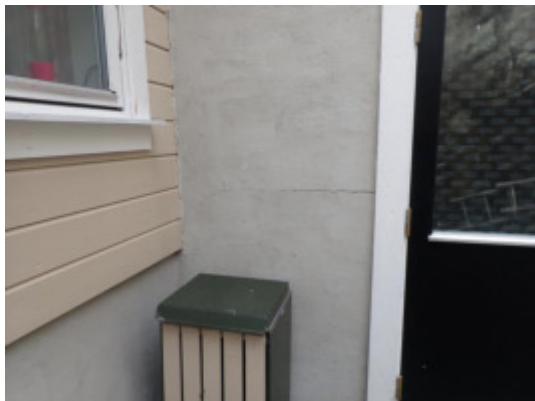
Det er registrert horisontal sprekk i grunnmur
