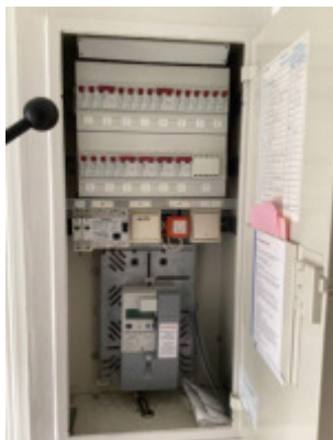
Anlegg med automatsikringer fra byggeår.
