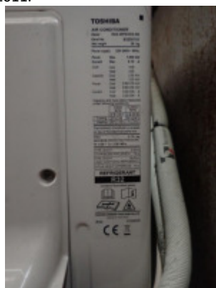
Varmepumpe av nyere dato
