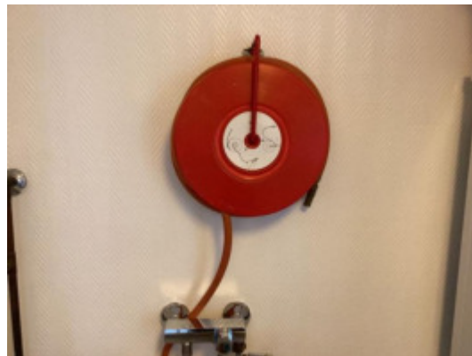
Brannslang montert på vaskerom
