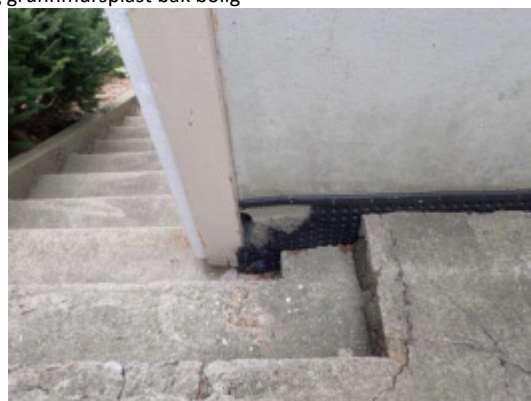
Mindre skade på hjørne
