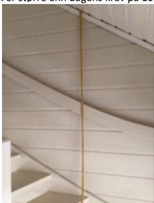
Det er liten frihøyde i trappeløp
