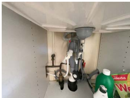
Del av rør til avløp.
