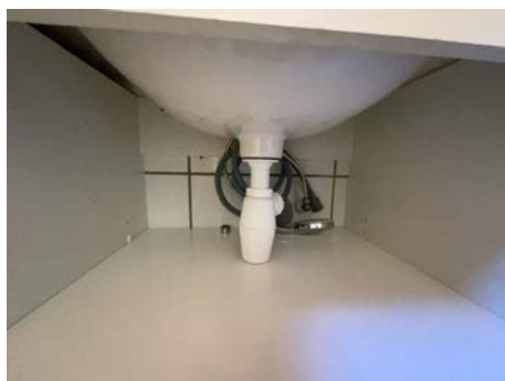
Del av rør til avløp.
