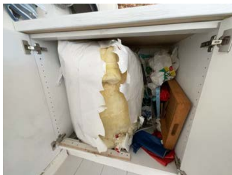
Varmtvannstank i kjøkkenskap.
