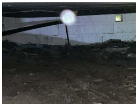
Del av rør til vann. Stoppekran til vann.
