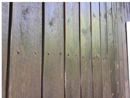
Dype spikerhuller i ytterkledning.
