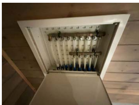
Skap til rør i rør system.
