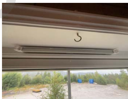
Eksempel på montert ventil i vindu.
