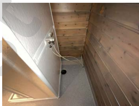
Sluk under dusjkabinett. Dusjkabinett er montert med fleksislinger og kan flyttes på for kontroll og rengjøring.
