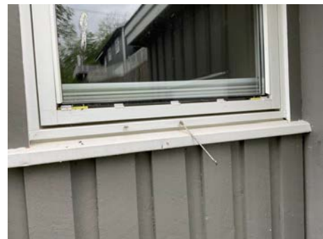
Vindu til bad mangler utvendig list.
