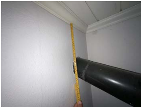
Røykerør går for nær trvirke
