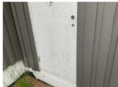
Dør til garasje må utbedres.
