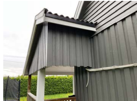
Mangler takrenne og nedløp.
