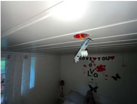
Løseledninger i himling i kjeller må utbedres.
