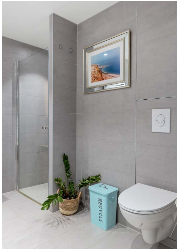
Vegghengt wc med fordelerskap over. Her finner du vannmålere til varmt og kaldt vann, samt den vannbårne varmen
