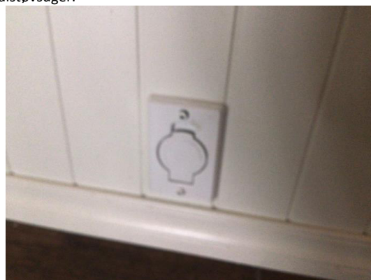
Eksempel på uttak til sentralstøvsuger.
