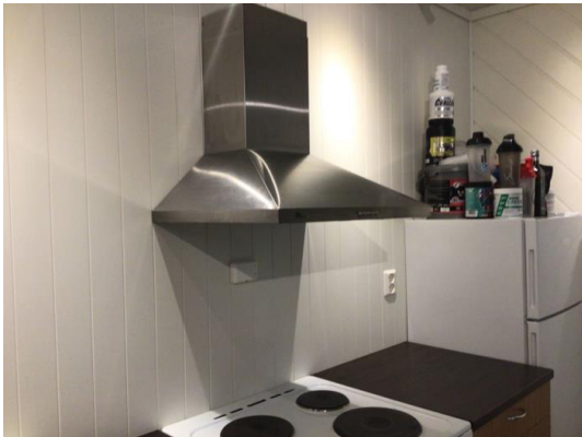
Montert avtrekk over komfyr.
