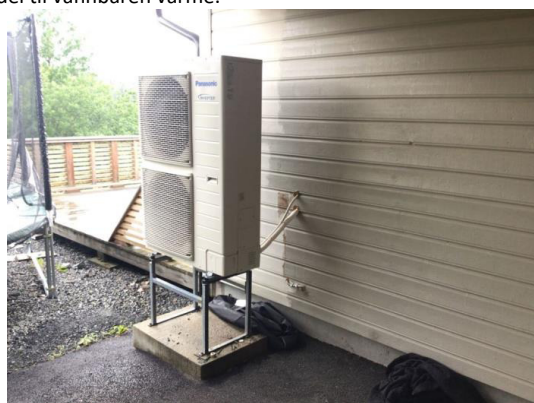
Utvendig del til vannbåren varme.
