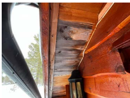
Fuktmerker på undertak.
