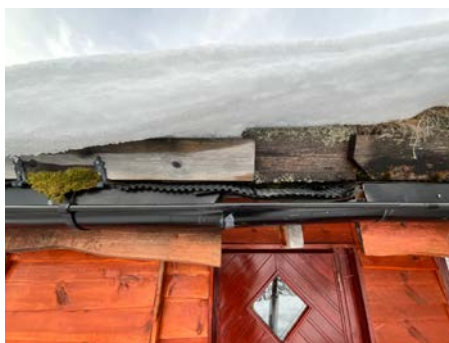
Ufagmessig skjøting av torvhaldstokk og fuktmerker.
