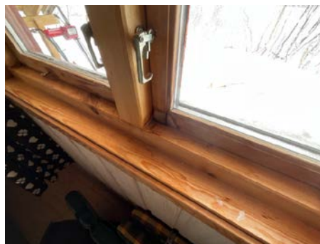
Fuktmerker på vinduer.
