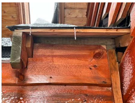
Lite lufting og synlig isolasjon mot takkonstruksjon.
