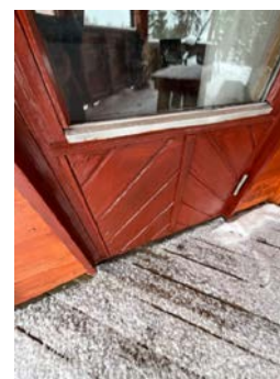
Alder og værslitasje på terrassedør.
