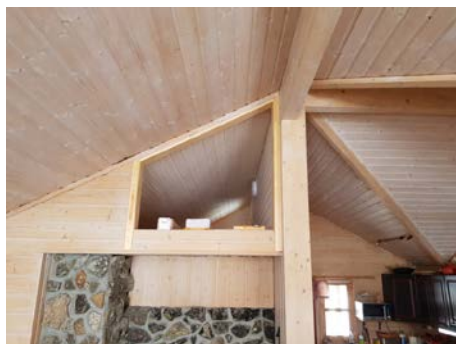
Tak sett fra stue.
