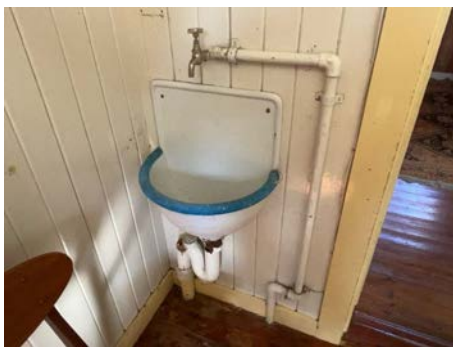
Avstengt utslagsvask i loftsetasjen.
