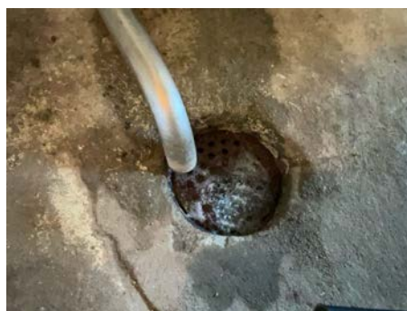
Sluk - Vaskerom - Rustsvekkelser.
