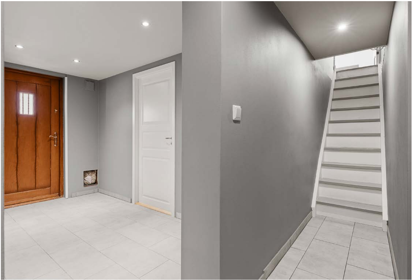
Trapp ned fra kjøkkenet til romslig gang i underetasje - Underetasjen er innredet og bruksendret uten søknad og er derfor ikke godkjent
