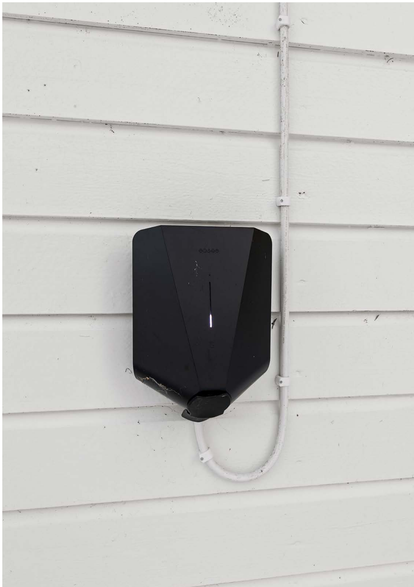
Easee elbillader montert på husvegg ved gårdsplass
