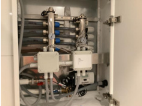
Rørskap bak vegghengt toalett.
