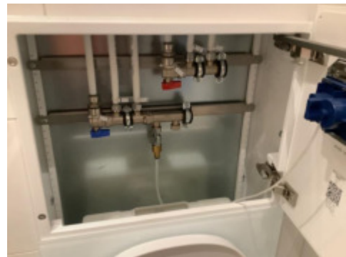
Rørskap bak vegghengt toalett.
