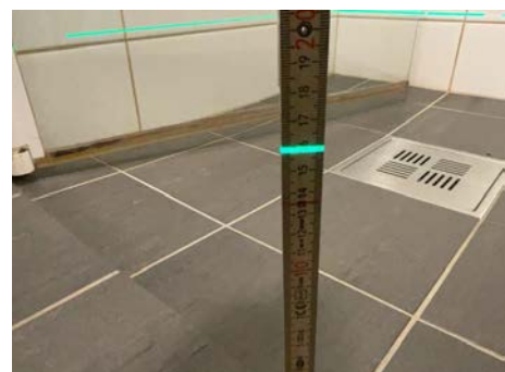
Foto viser total høydeforskjell mellom dør og sluk.
