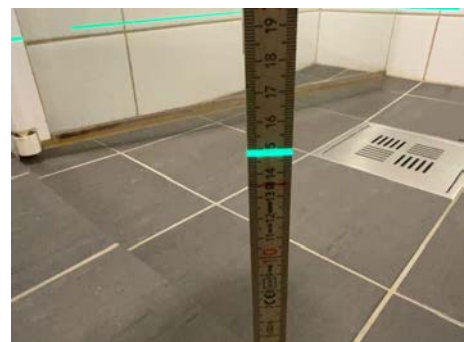
Foto viser fall før nedsenket dusjområde. (rød strek er 0 punkt)
