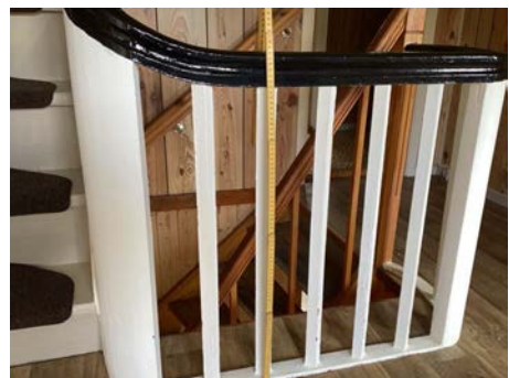
Rekkverk lavere enn dagens krav.
