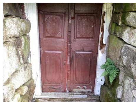
Eldre kjellerdør med råte i karm og ramme
