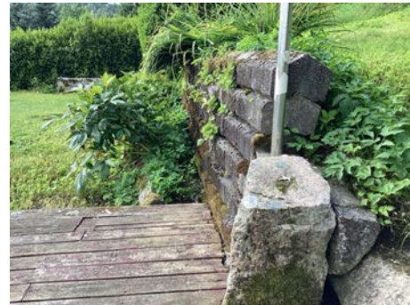
Skjevheter grunnet jordtrykk
