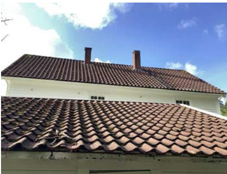
Taket har ikke snøfanger. Et pipeløp har ikke stige
