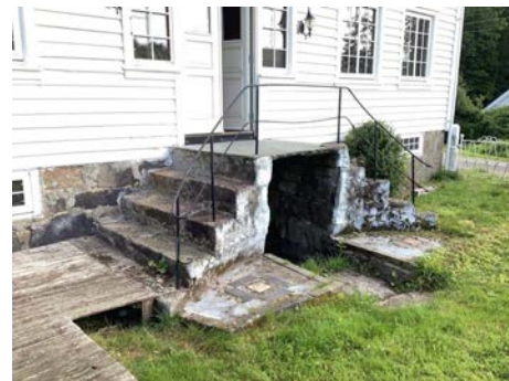
Rekkverk er lavere enn dagens krav. Åpninger i rekkverk er større enn dagens krav. Det er ikke håndløper på vegg
