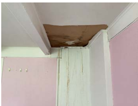
Spor etter vannskade i himling
