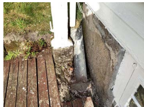
Feil ved bortledning av vann fra nedløp
