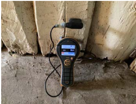
Råteskade i treverk
