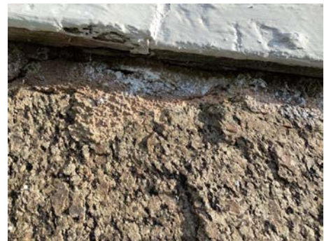
Ingen lufting bak kledning
