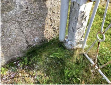
Nedløp fører til terreng
