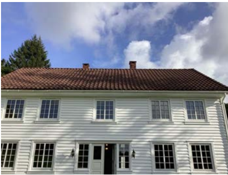
Taket har ikke snøfanger
