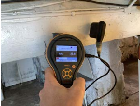
Påvist fukt på 22,8 Vekt % på bjelker i kjeller
