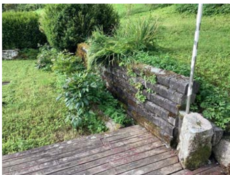
Mur har ikke sikring
