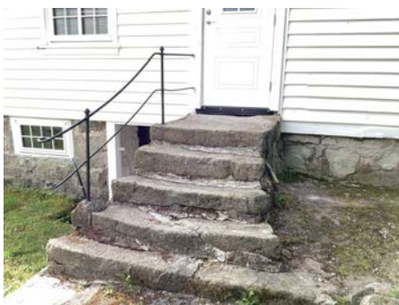
Rekkverk er lavere enn dagens krav. Åpninger i rekkverk er større enn dagens krav. Trapp mangler rekkverk på en siden
