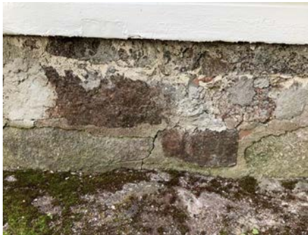
Mindre skader i fuger
