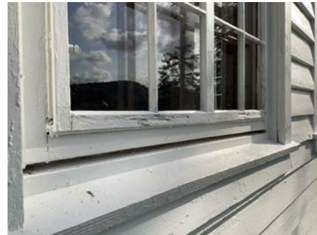
Råteskader på sprosser
