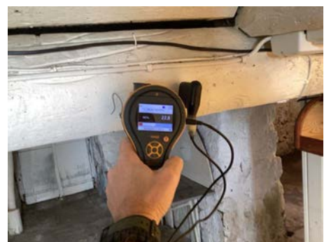
Høye fuktverdier på bjelker i kjeller
