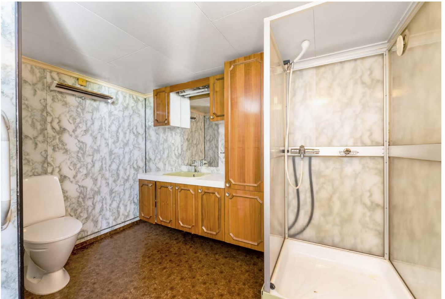
Eldre bad med belegg på gulv og baderomsplater på vegg. Badet er innredet med baderomsinnredning, toalett og dusjkabinett.
