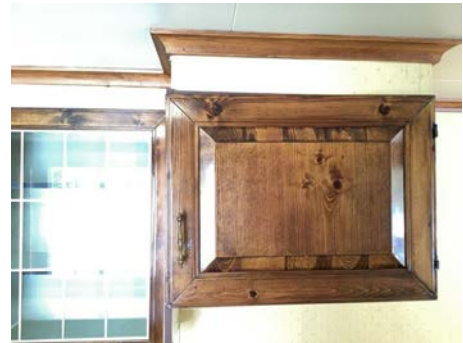
Skjevheter i innredning
