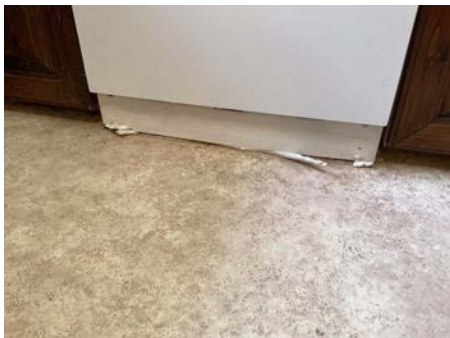
Skader på overflate
