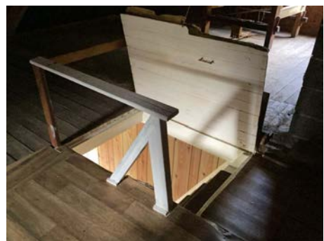
Store åpninger i rekkverk på loft
