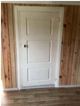
Eldre dør fra byggeår, vanskelig å lukke
