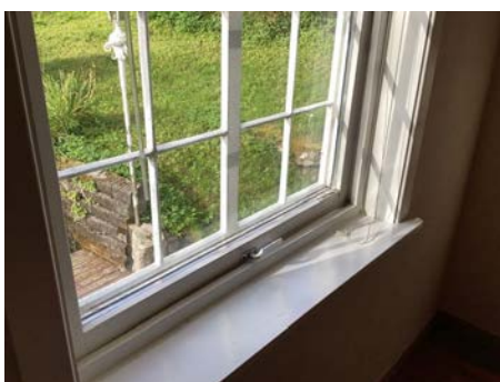
Vindu i stue, vanskelig å lukke
