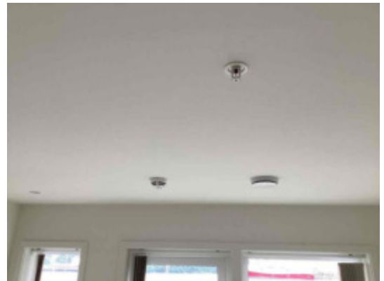
Sprinkleranlegg og røykvarsler
