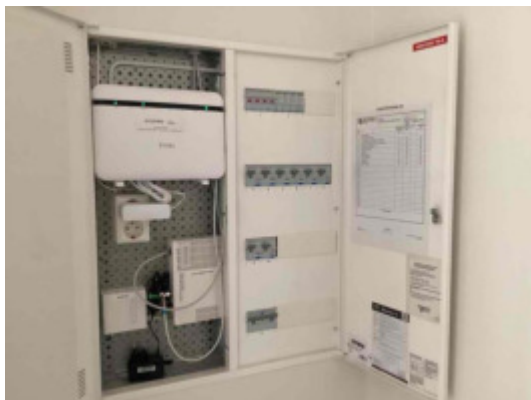
Sikringskap med kursfortegnelse.
