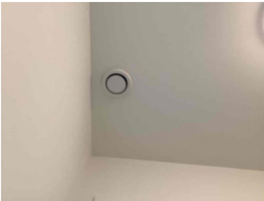
Avtrekk i himling
