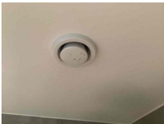
Avtrekk i himling
