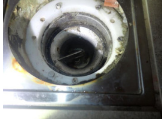
Klemring er tilstrekkelig festet, men enkelte skruer stikker opp.
