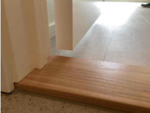
Spalte ved terskel
