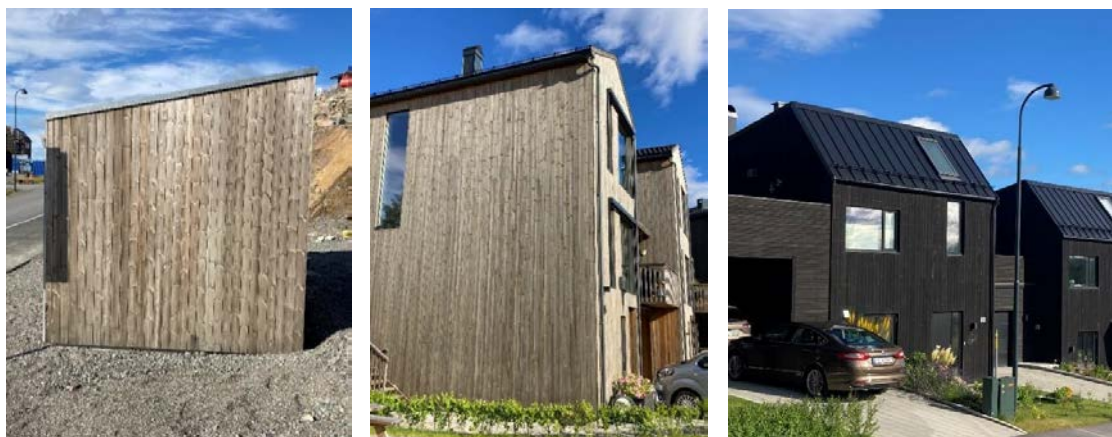
Eksempel fra Drangsvann på ulike typer trekledning. Tv. Varmebehandlet furu. M. Royalimpregnert kledning upigmentert vågrå. Th. Royalimpregnert kledning nordisk sort RS.30
