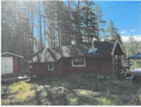
Delvis takrenne og nedløp mangler
