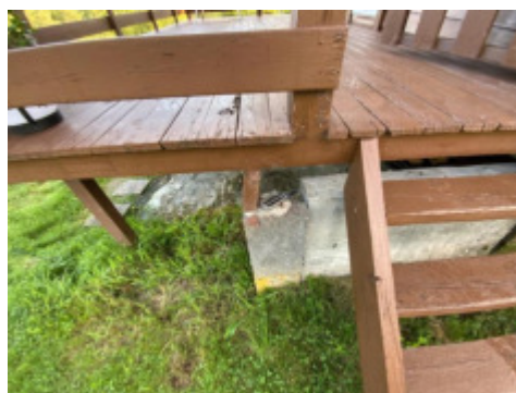
Avvik på understøttelse av søyle.
