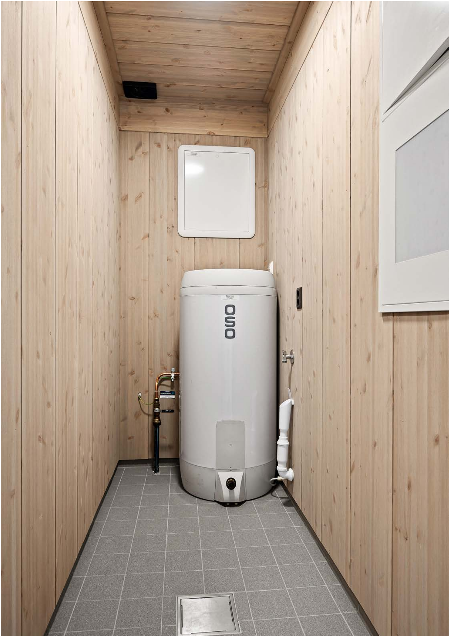
Kombinert teknisk rom/bod - og vaskerom. Her er det opplegg til vaskemaskin, el.tavle, rørfordelingskap og varmtvannsberederen plassert.
