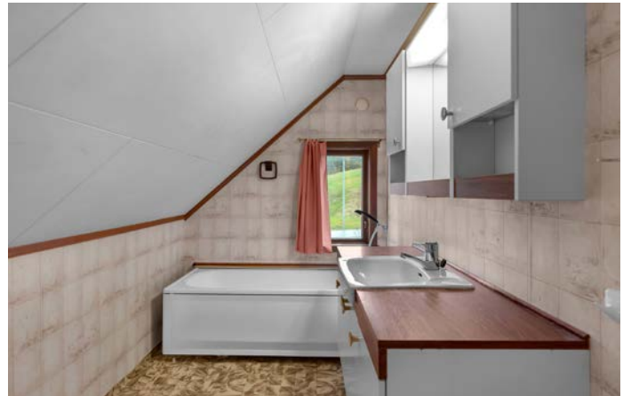
Eldre bad med belegg på gulv.
