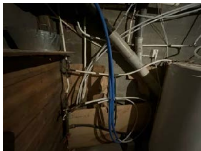
Vannledninger av kobber.
