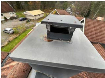
Noe rustdannelse på pipehatt.
