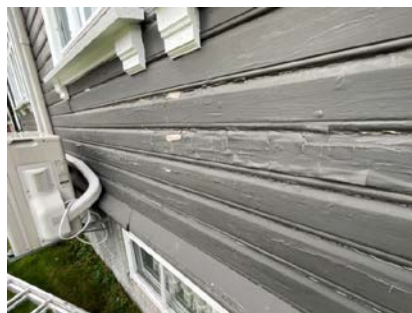
Malingsflass på kledning.
