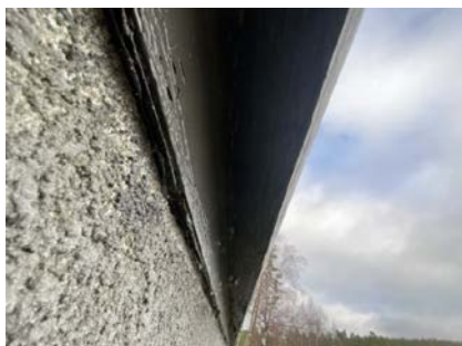
Ingen lufting bak kledning.
